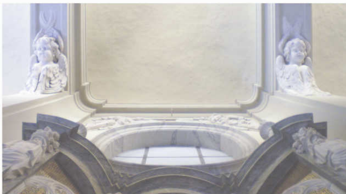
Fig. 4_ La trabeazione deformata vista dal basso.
