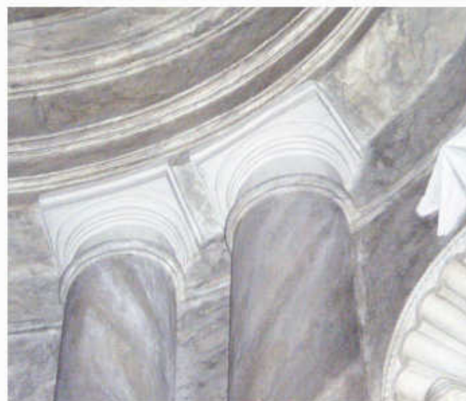
Fig. 7_ Capitelli deformati in funzione dell'architrave.
