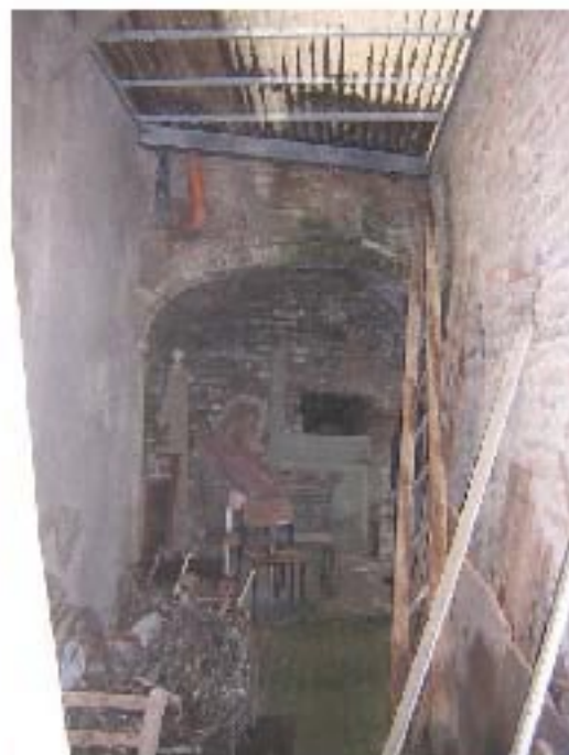
Figura 103 - Grottoammare. Chiesa di Santa Lucia. Interno. Corridoio di passaggio al matroneo sud-ovest (foto Corona).
