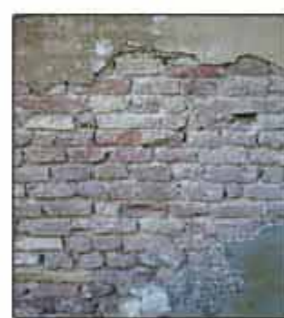
Particolare del prospetto a monte; dal distacco dell'intonaco è venuta alla luce una muratura in mattoni la cui finitura grossolana, un impasto poco uniforme e il colore chiaro lasciano intendere un'epoca ancor più antica.
