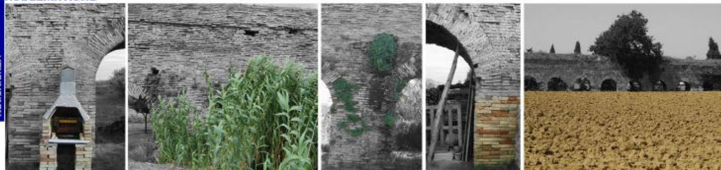
OGGETTI E VEGETAZIONE ADDOSSATI
