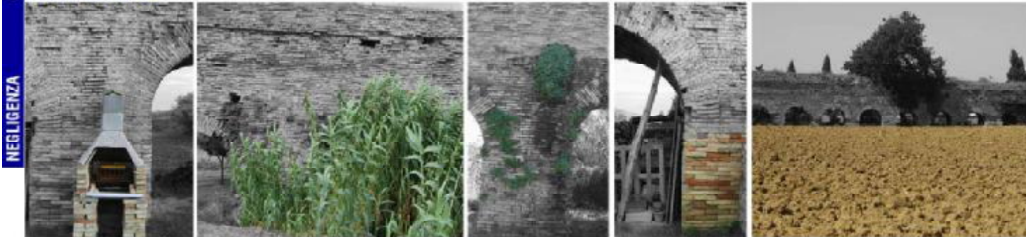
OGGETTI E VEGETAZIONE ADIOSAITI ERBE INFESTANTI MATERIALI NON COMPATIBILI TERRENO LAVORATO A RIDOSSO DEL MANUFATTO
