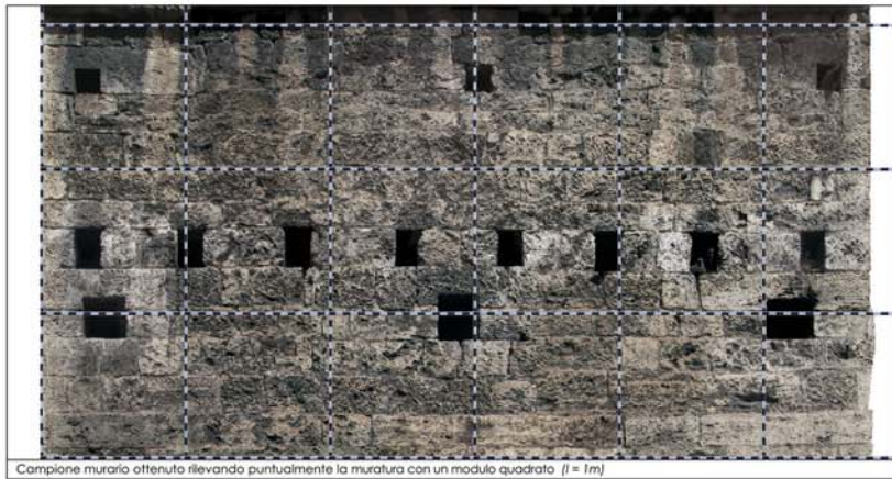
Campione murario ottenuto rilevando puntualmente la muratura con un modulo quadrato (l = 1m)
