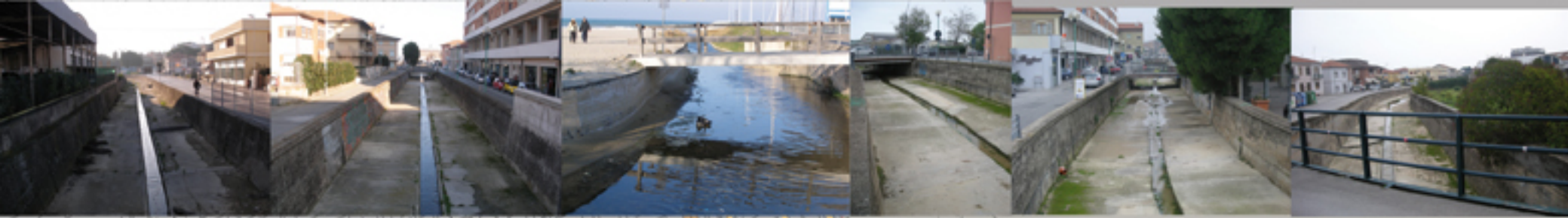
degrado del corso del castellaro all'interno del tessuto urbano
