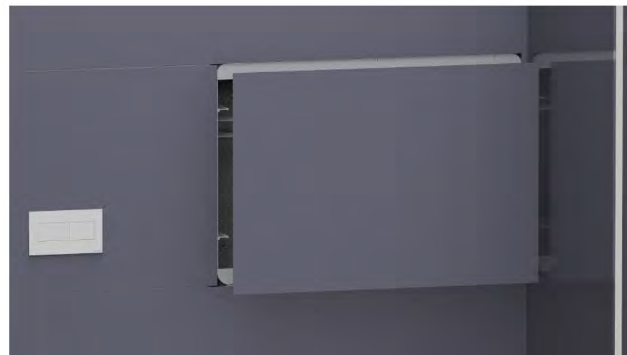
1 ESTRAZIONE DEL PANNELLO CIRCOSTANTE IL GUASTO
