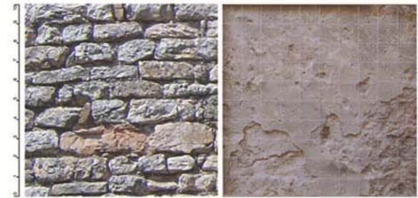
Muratura in conci di pietra calcarea irregolare proveniente da cava locale, filari orizzontali, colore grigio.
