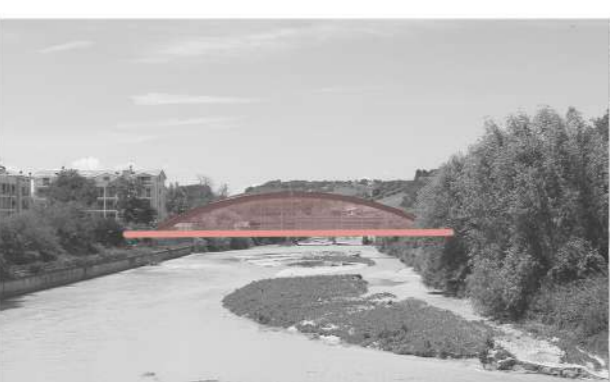
Il ponte ciclo-pedonale inagibile che connette le sponde del fiume Potenza che è circondato da verde ripariale
