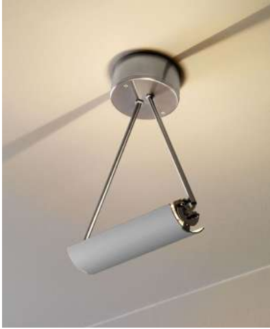
Singolo a soffitto
